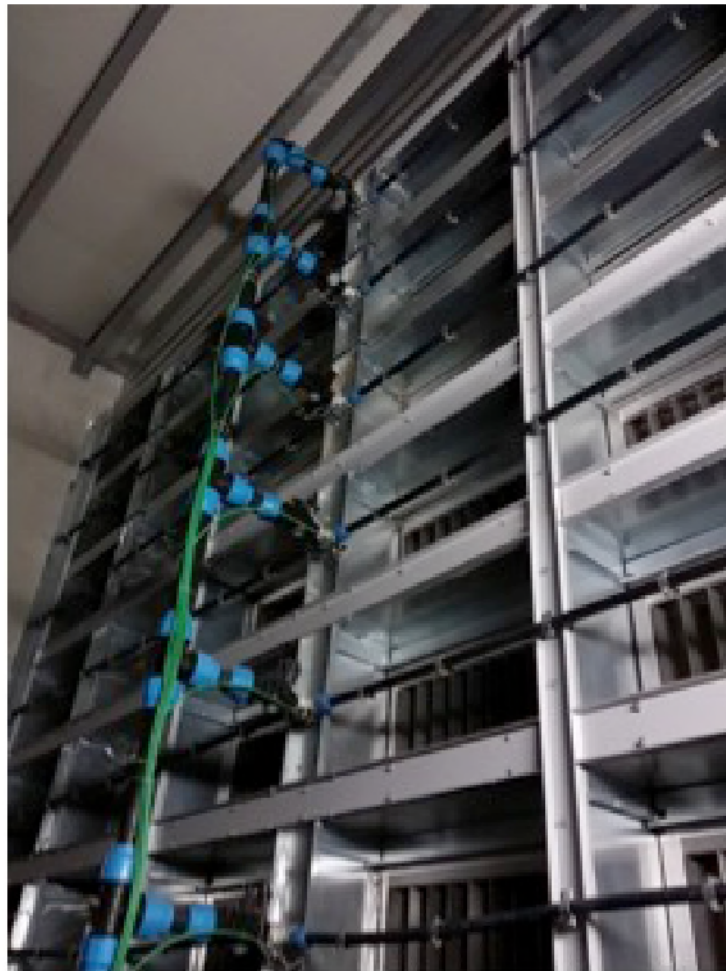
Ilustración 7 - Imagen de los filtros electrostáticos de un sistema de purificación de aire
